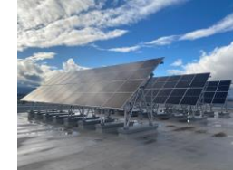
太陽光パネル
